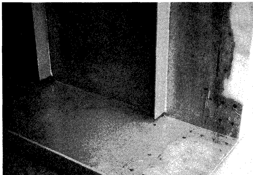
タールエポキシの 変色状態
