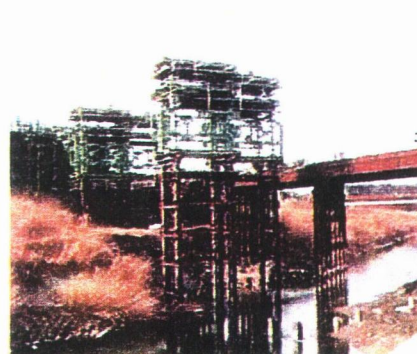
ベント設備(河川内ベント)
