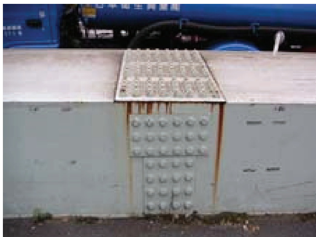
写真 2.4.4 下路式主桁の腐食事例
