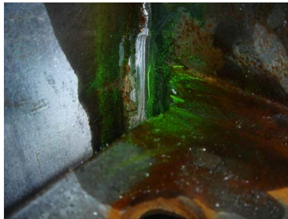
図 3-2-1 溶接割れ発生箇所（磁粉探傷）
