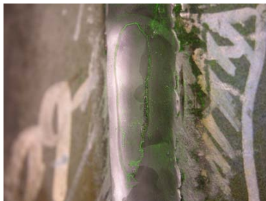
溶接割れの写真
