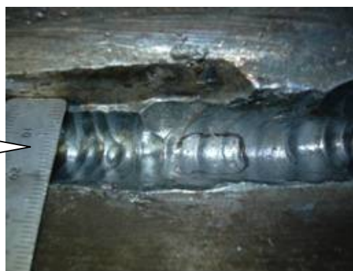
溶接割れの写真
