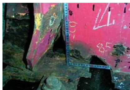
写真-1 腐食箇所が破断した例 表-1 腐食パターンの分析
