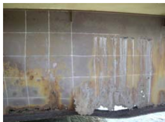
図-2 桁端部による崩落前の腐食状況
