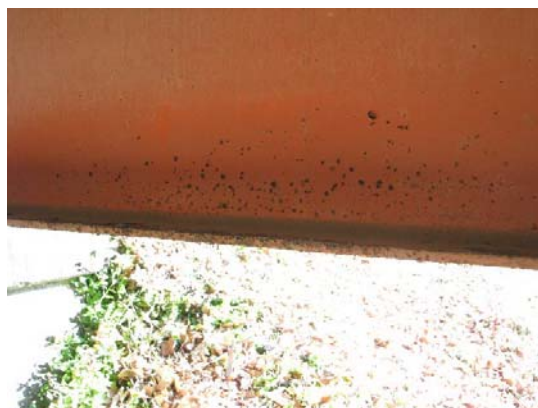
図 4-4 主桁 Mg0202 の損傷写真（試験施工対象範囲）
