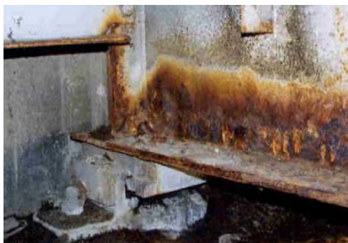
劣化の早い部位 (桁端部の腐食事例)
