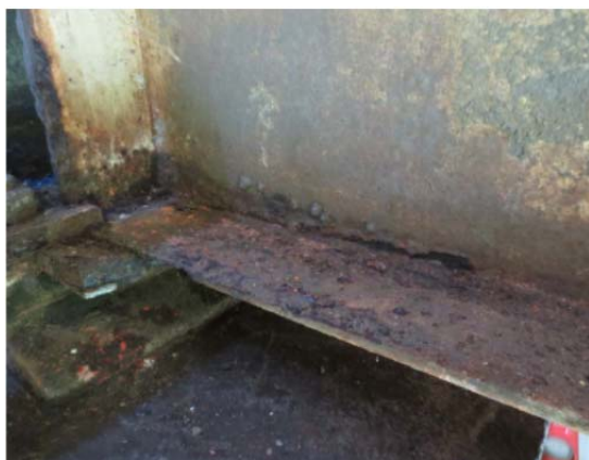
a) 桁端部の腐食事例
